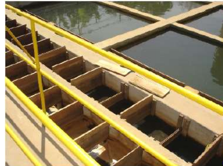
Floculadores e Decantadores da ETA Fonte: Plano Diretor Alexânia - Lei Complementar nº 892/2.006
