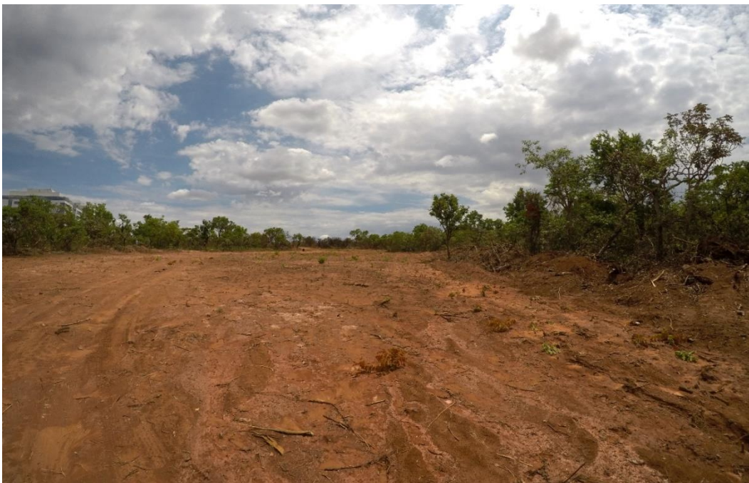
Figura 10 - Santuário dos Pajés; Brasília - DF. Área desmatada para a construção da Via W9
