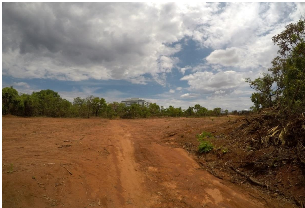
Figura 9 - Santuário dos Pajés; Brasília - DF. Área desmatada para a construção da Via W9
